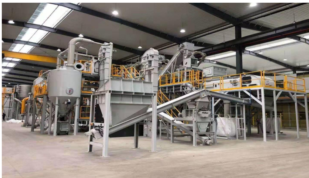
废电冰箱拆解线
