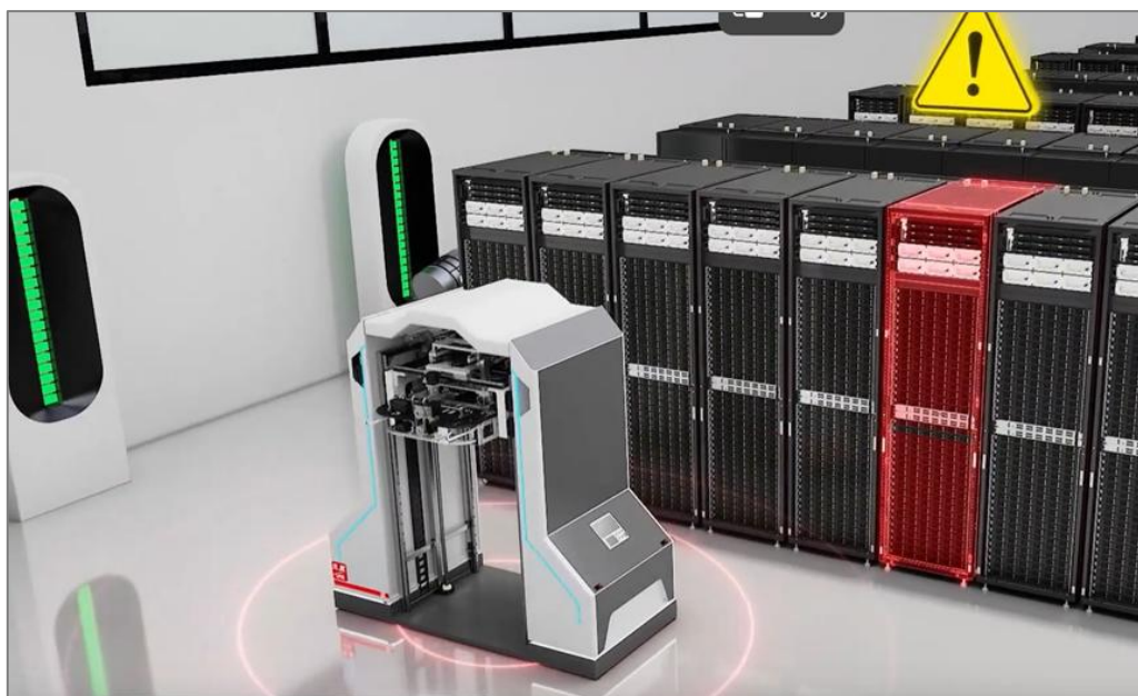
数据中心机器人智能运维
