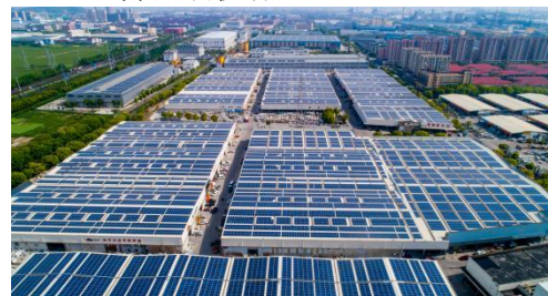
嘉兴长三角国际石材城有限公司 并网装机容量：9.25MW
