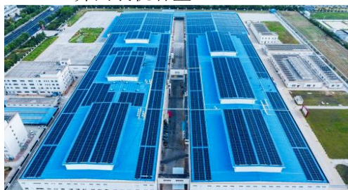
旺旺集团漯河大旺 并网装机容量：4.56MW
