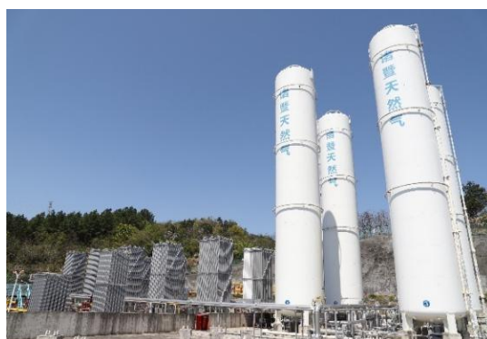
诸暨市天然气利用工程-门站及应急调峰站
