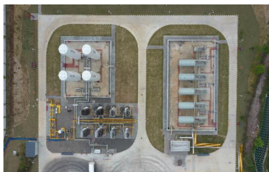
东阳市横店燃气总站
