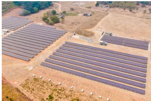
巴西 1.3MW 项目
