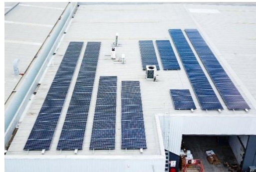
澳大利亚 30kW 项目
