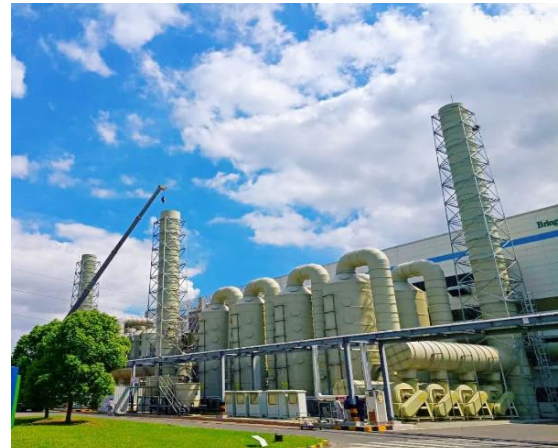
（扬州协鑫光伏项目）
